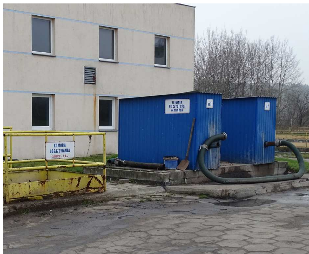
Stacja zlewna ścieków dowożonych przed.
